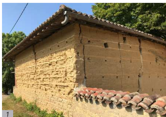
1 : Fissuration et lessivage du pisé sur une ancienne ferme à Saint-Étienne-sur-Reyssouze
