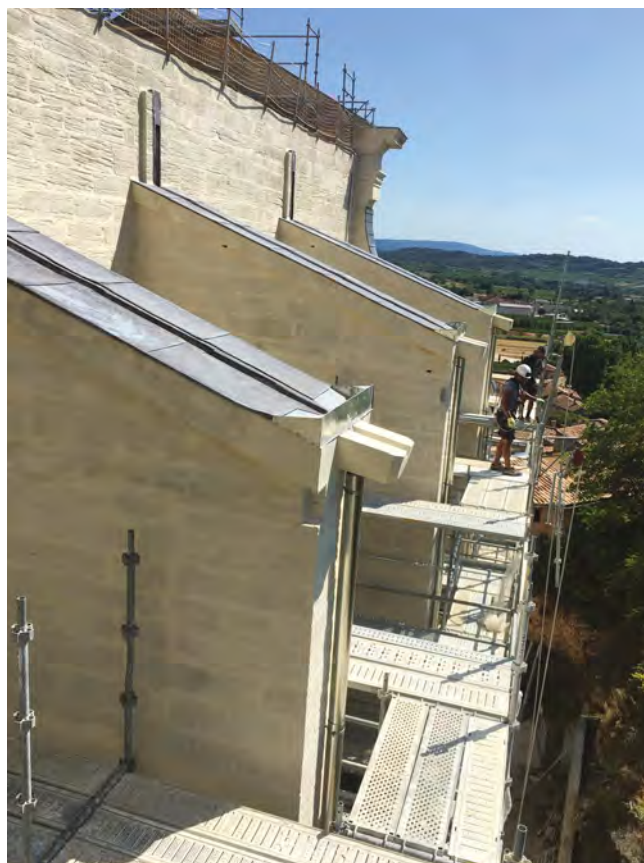
Figure 13 : Bédoin, Eglise St Pierre, récupération des eaux de pluie 2019
