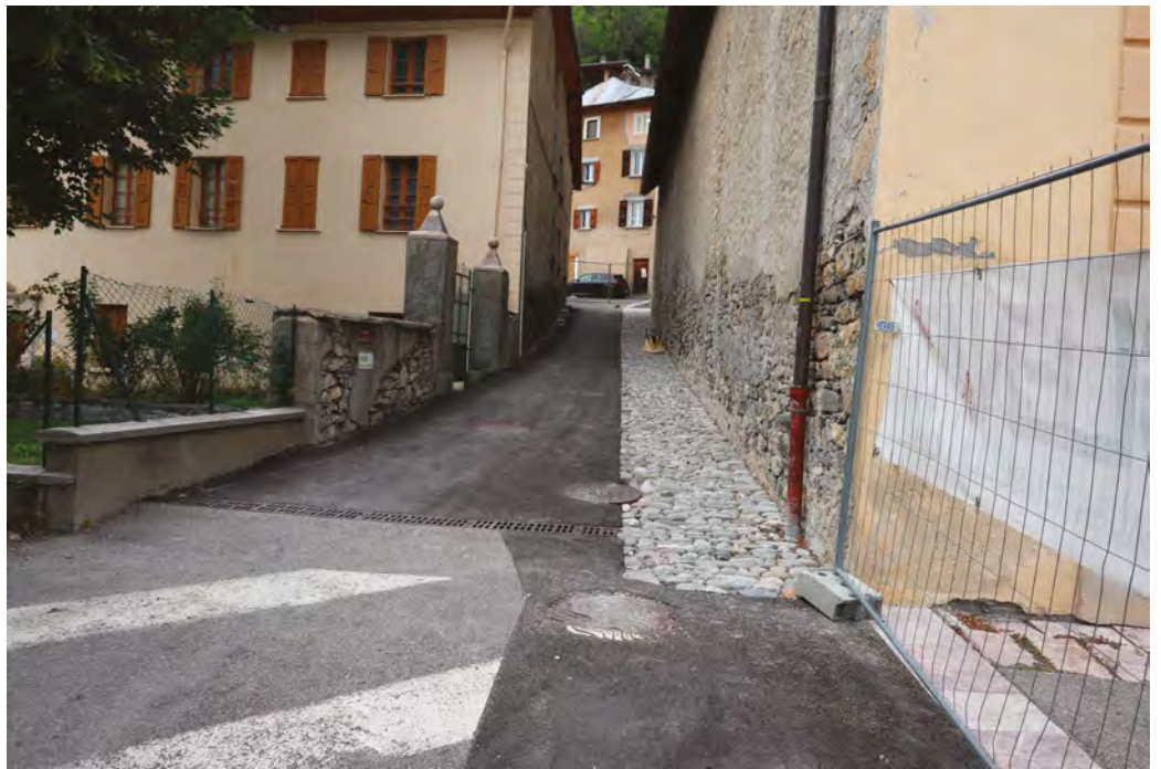
Fig. 6a et 6b : L'aqueduc-drain en cours de travaux et après travaux (2019) © Philippe Bromblet - CICRP
