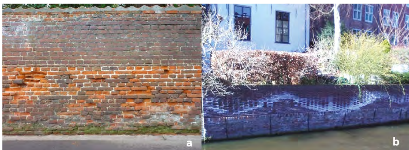
Figure 2 : Symptômes de l'humidité ascensionnelle. (a) dégradation d'un mur de brique sur 1 mètre de hauteur. (b) Efflorescences de sel sur la zone d'équilibre, ou s'évapore l'eau des remontées capillaires.
