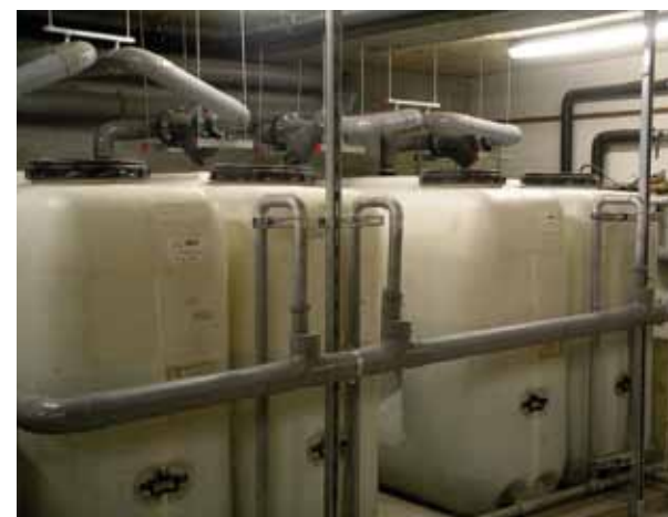
▼ Fig. 89 – Récupération d'eau de pluie dans un bâtiment public pour alimenter les chasses d'eau
