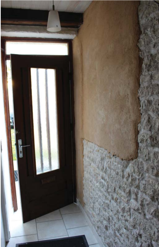
Mise en oeuvre d'un enduit terre (phase de chantier) dans une maison à MOUTROT Photo de Jérémy PELTIER et Eugénie THUILLIER
