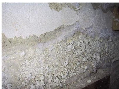
Présence de salpêtre (Photo : humidites.fr)
