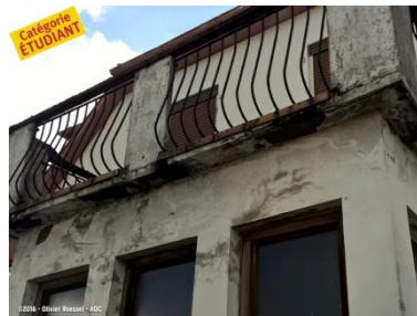
Absence de dispositif anti goutte d'eau en nez de terrasse (photo : AQC)
