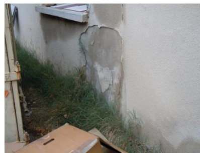
Traces d'humidité et enduit extérieur dégradé
