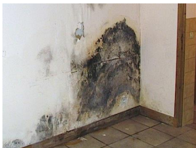
Présence de moisissures (Photo : prix-immobilier.info)
