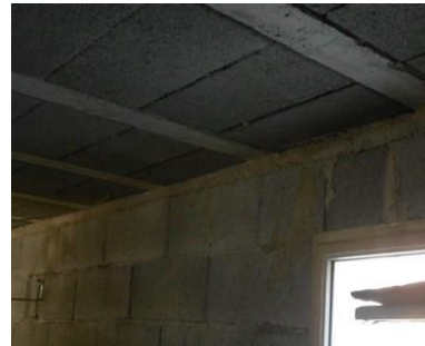
Exemple de dalle hourdis en béton (maison années 1980) non enduite en sous face
