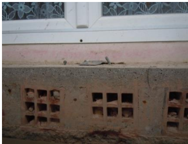
Exemple de dalle poutrelle-hourdis de terre cuite (immeuble années 1950) sciée au niveau d'un balcon
