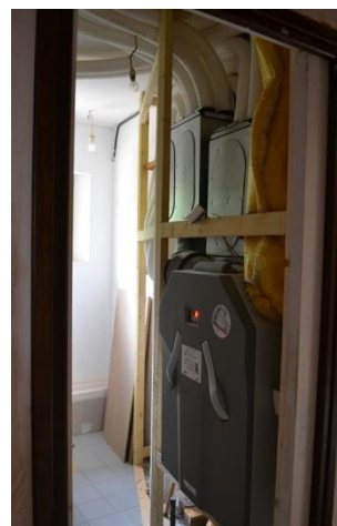
Exemple de ventilation double flux en maison individuelle
