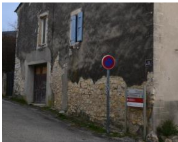
Enduit ciment craquelé sur mur en pierre
