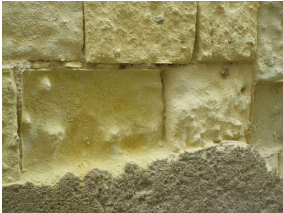
Figure 2-20 : Pierres de taille en tuffeau dégradées par alévolisation à l'interface avec le soubassement. Celui-ci a été enduit de ciment, le rendant étanche $
