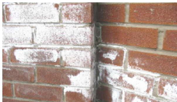
Exemple d'efflorescences de sels.
