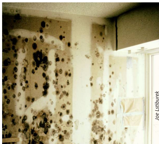
Exemple de moisissures dues à la condensation.
