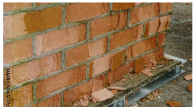
Exemple de briques gélives soumises au gel.
