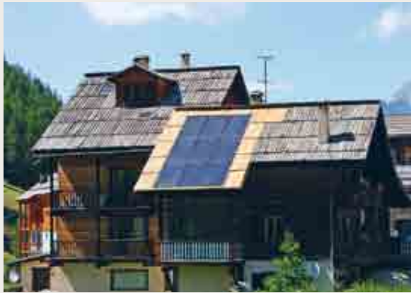
Molines : capteurs intégrés dans une couverture en bardeaux de mélèzes. La partie neuve en mélèze va griser rapidement
